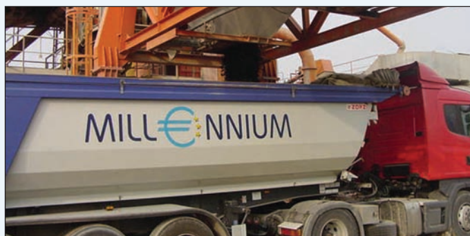
La fase di scarico del conglomerato bituminoso tiepido in assenza totale di fumo
